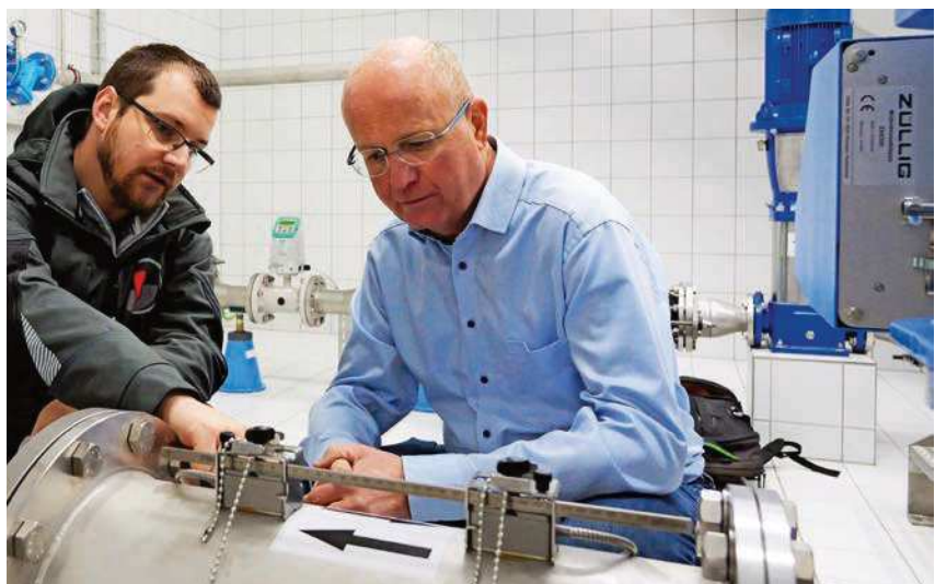
Marc Kast und Georg Matt besprechen eine mobil installierte Clamp-On-Messung im Reservoirauslauf.
