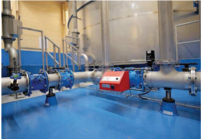
Armaturen zur Steuerung mit dem Rundbehälter Gantenstein im Hintergrund.
