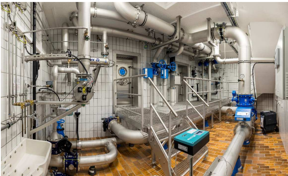
Oben die neue Beschichtung vom Reservoir Schaanwald. Unten die Innenansicht vom Rohrkeller.
